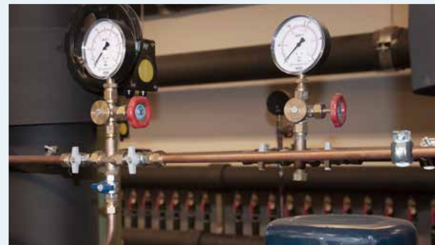
ALLT SKÖTS FRÅN "MEDIARUMMET". I BAKGRUNDEN SYNS BERVÄRMEANSLUTNINGARNA.
